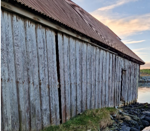
Figur 4. Eks. naust på Kvitsøy. Selv om sjøhuset er i forfall, er kledningen et godt eksempel på type og dimensjon på original kledning.
