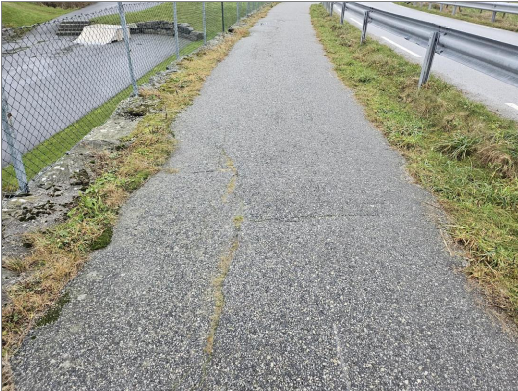
Figur 9. På strekningen klubbhuset til kryss inn til skolen (20) har underlaget på gang-/sykkelstien lav kvalitet, tatt 11.12.2025 av Tormod Høie Meling.
